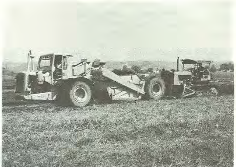
Kloten baut - Riesige Baumaschinen haben mit den Aushubarbeiten für den Pistenausbau begonnen.
